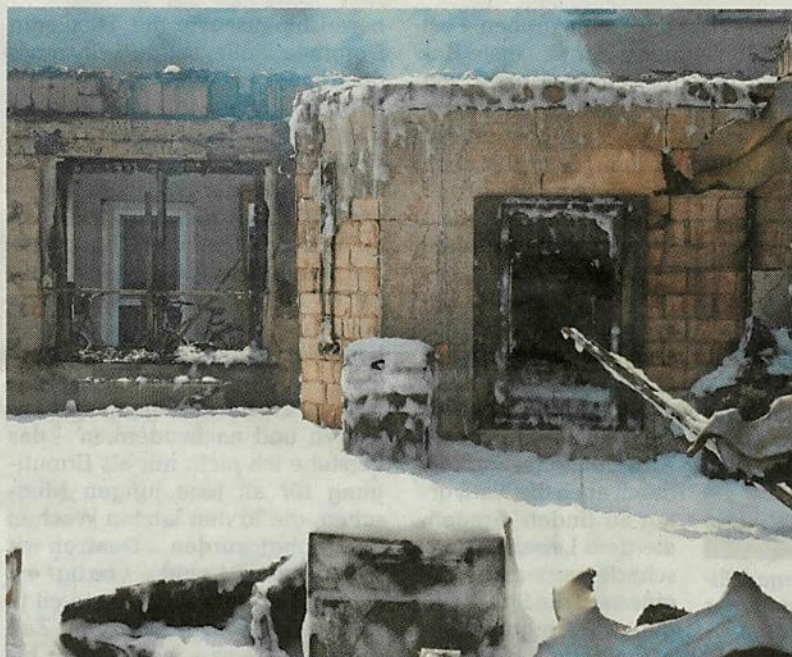
Der Flachbau ist komplett ausgebrannt.
